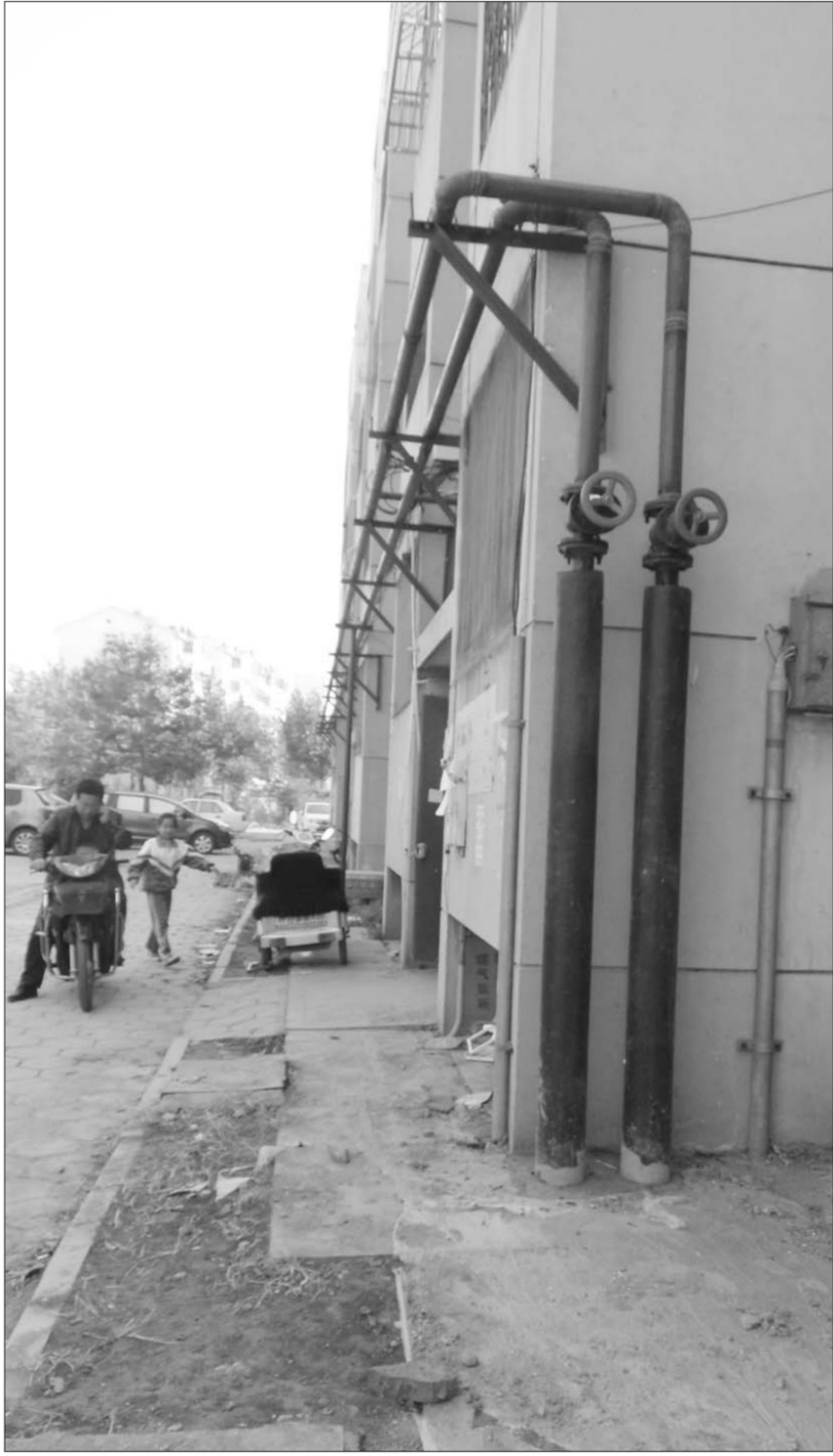
铁路安民小区经过供暖改造,一户一个开关。本报记者任洪忠摄
