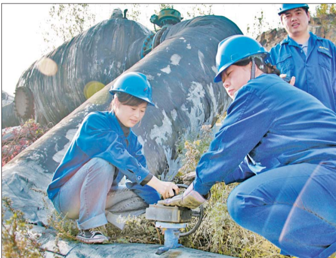
25日,威海热电集团工作人员打开了外网供水主管道,上水正式开始。 记者 王震 摄
