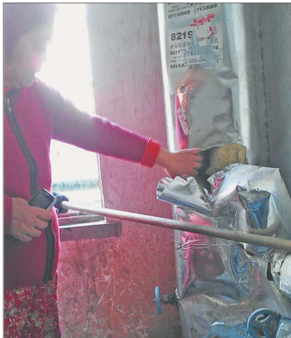
楼道内的管道漏水,居民只能拿着盆来接水,并不时用拖把拖地。 实习生 孙宝琴 摄
