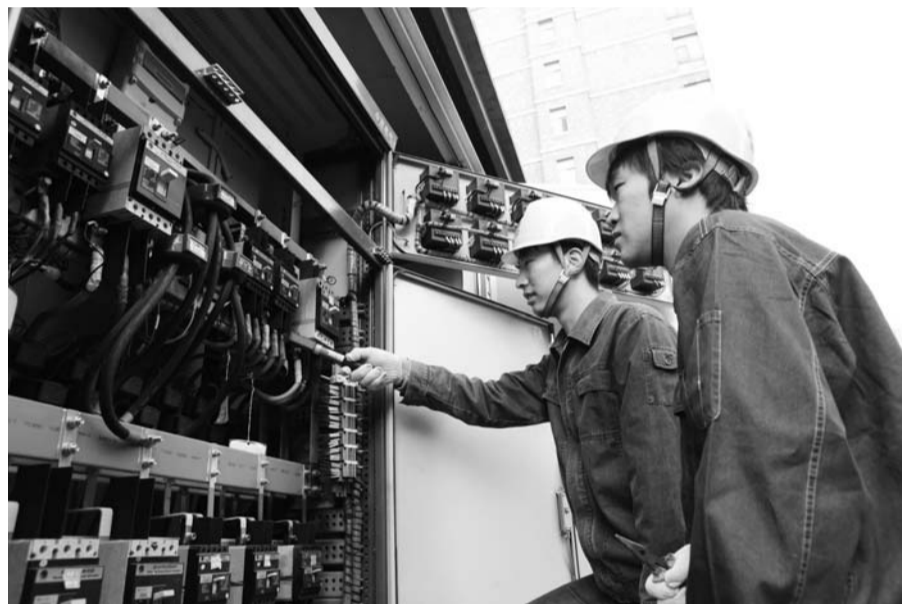
工作人员对小区内的低压箱进行检修。 本报通讯员 王衍 摄
