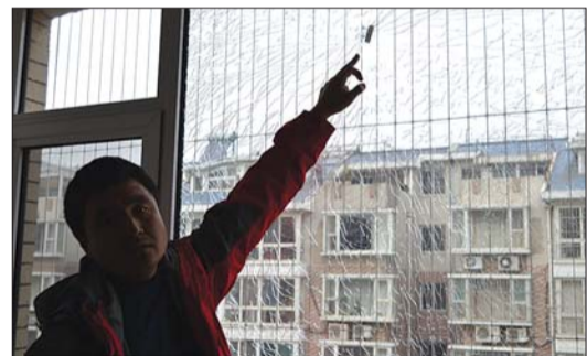
玻璃被打了个洞,全是裂纹。本报记者 陈新 摄
