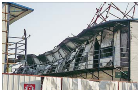
被烧坏的工棚 见习记者 朱洪蕾 摄
