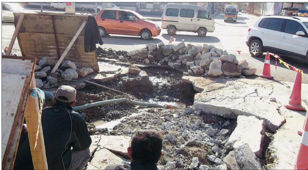
路面塌陷的大坑 见习记者 朱洪蕾 摄
