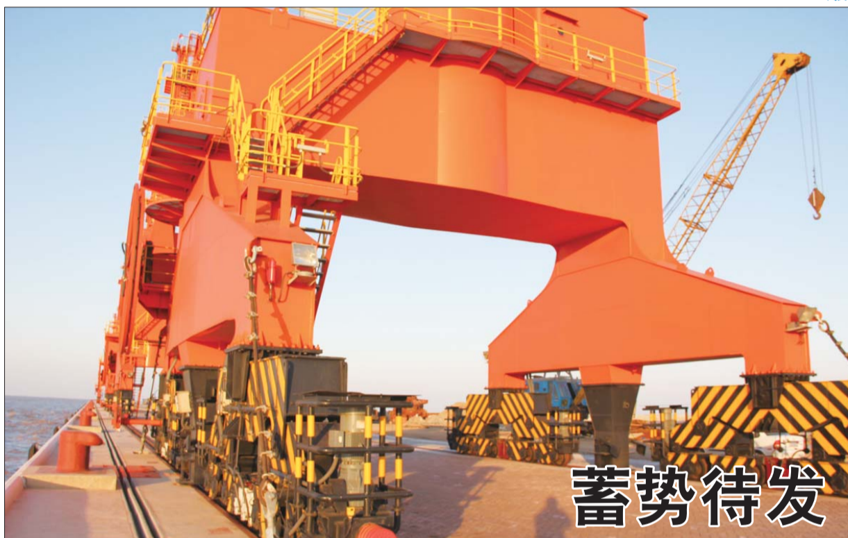
滨州港四座40吨级、变幅达33米门座式起重机在10月初安装完毕,今年各项建设工程进入收尾阶段,已具备正式通航条件。按照现在的航道条件,滨州港已经可以出入和停靠万吨级船舶,而等全部设施施工完毕后,滨州港可以满足3至5万吨级船舶停靠。图为重达40吨的门座式起重机。 本报记者 张卫建 杨玉龙 摄影报道
