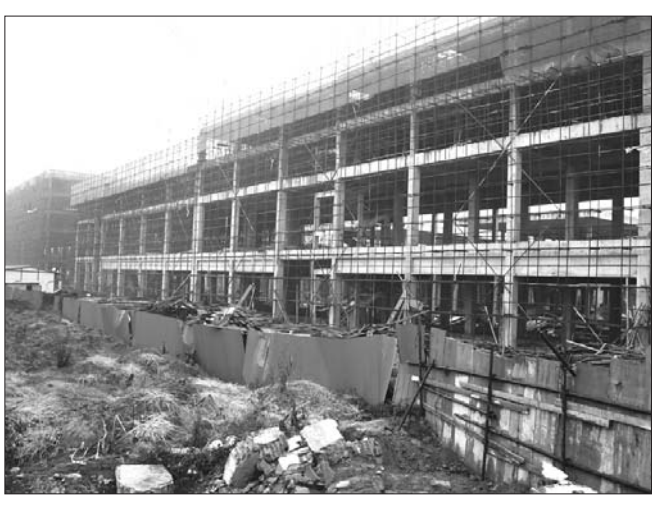
事发现场堆积着掉落的木板和脚手架。
