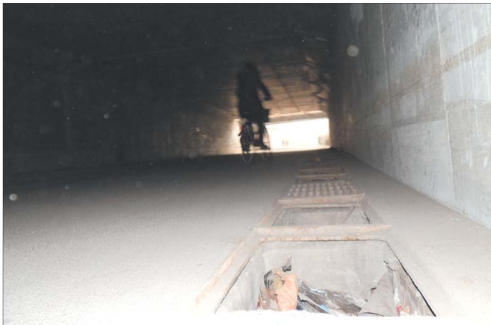
卞女士摔伤的路段,有不少井算子丢失,深约1米的雨水井实在“坑”人。
