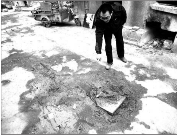
污水外溢的下水道。本报见习记者 张林 摄
