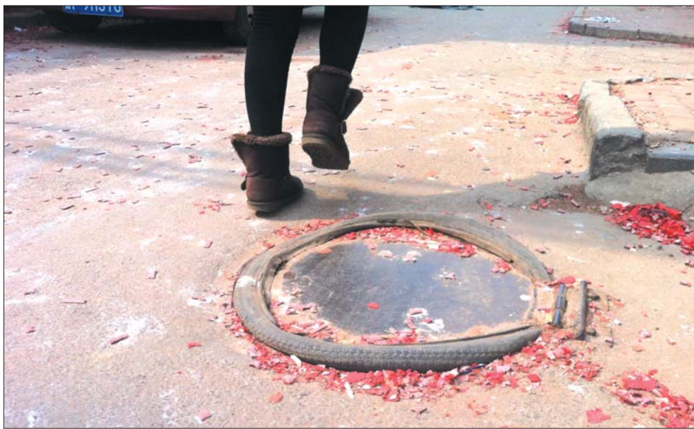
兴隆街的井盖外圈多了层胶皮圈。记者 曲彦霖 孙淑玉 摄
