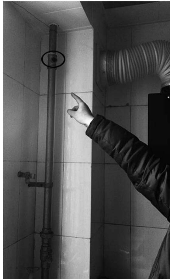
李先生家的天然气管道连表都没有安装,接口都是断开的。
