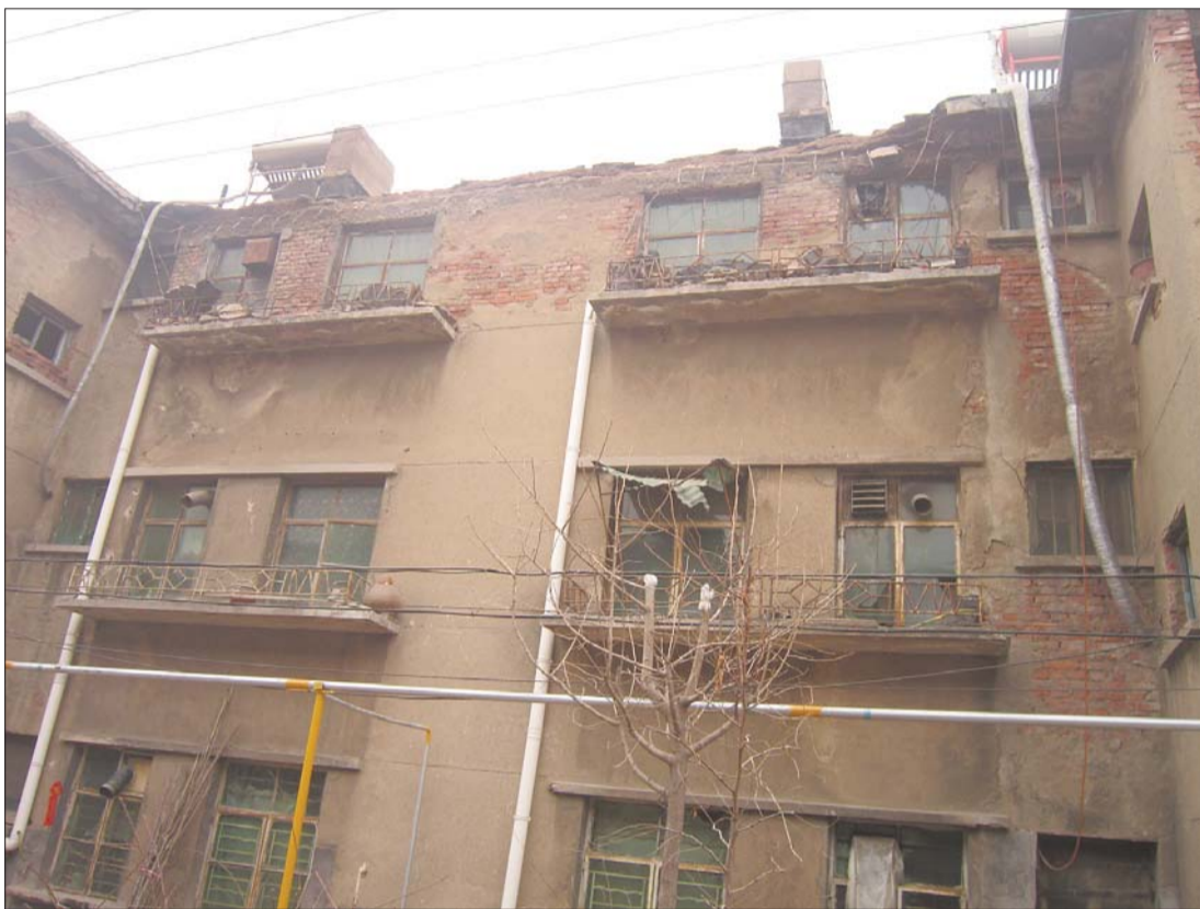
三楼住户顶楼坍塌严重。
