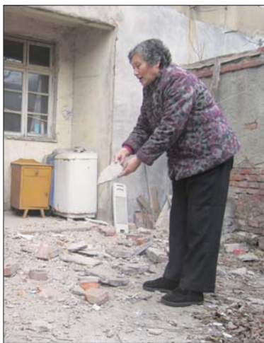
顶楼掉下来的墙皮散落一地。
