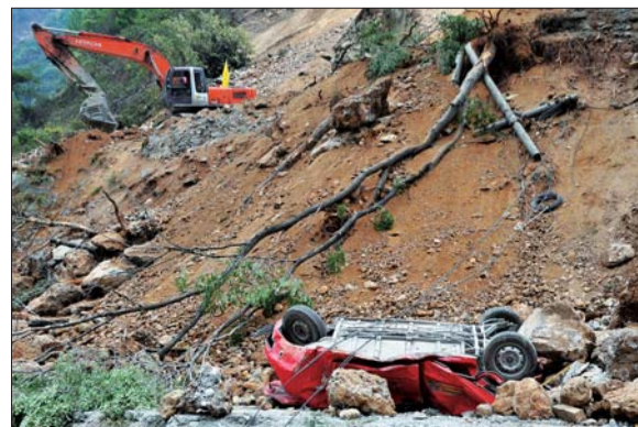
工程车正在清理塌方路段,下方有一辆损毁的轿车。
