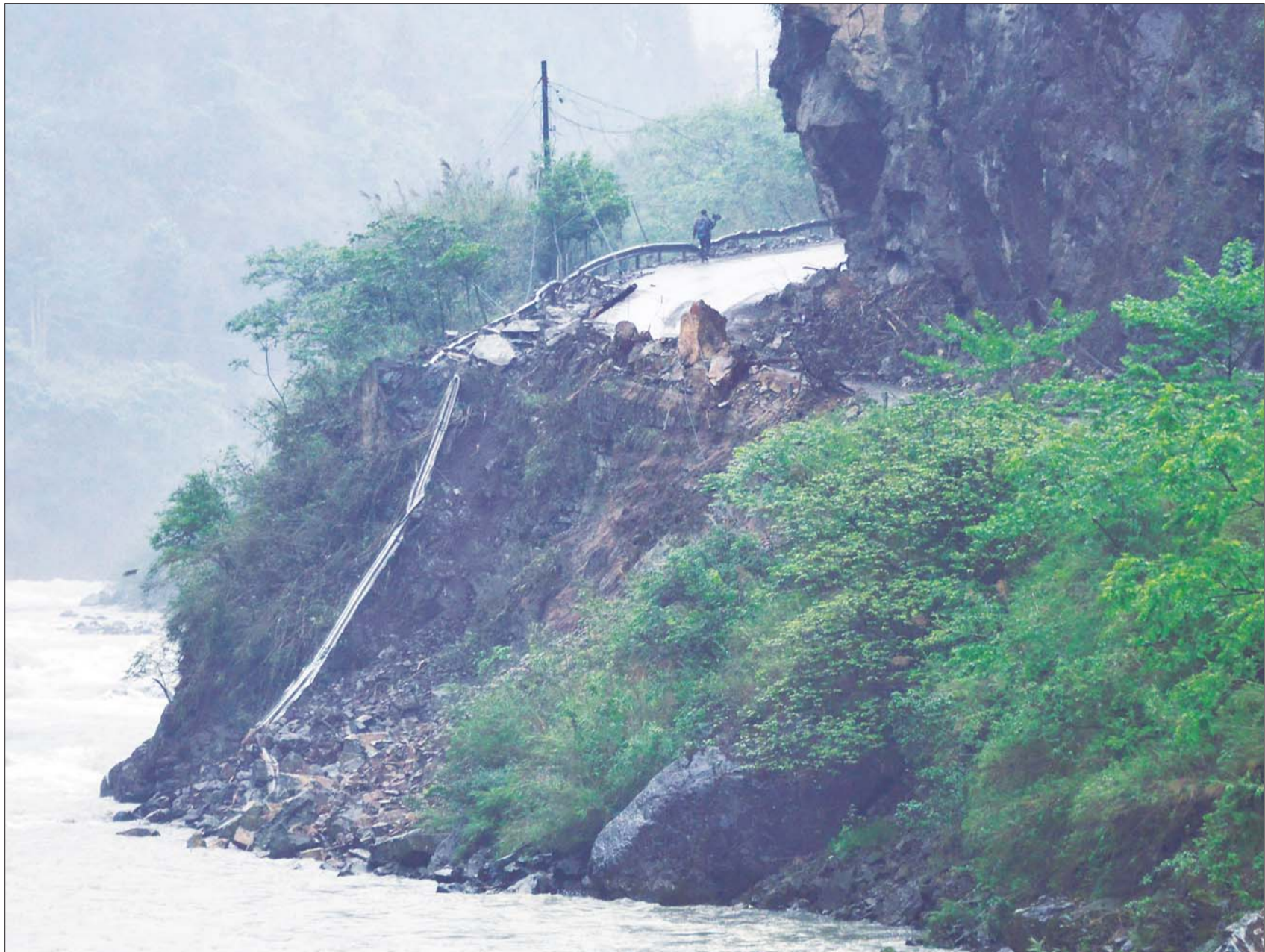
22日,芦山通往宝兴的路上,塌方造成路基塌陷。
