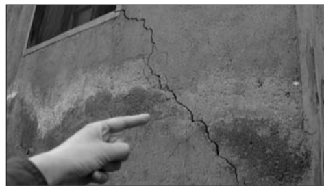
▲土坯建造的不少房子已经有了裂缝。
