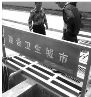
▲人民路一正在施工的建筑工地,车轮冲洗装置几成摆设。
