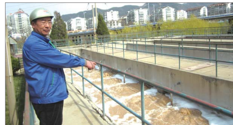
啤酒厂污水净化站正在处理污水。 记者 侯艳艳 摄
