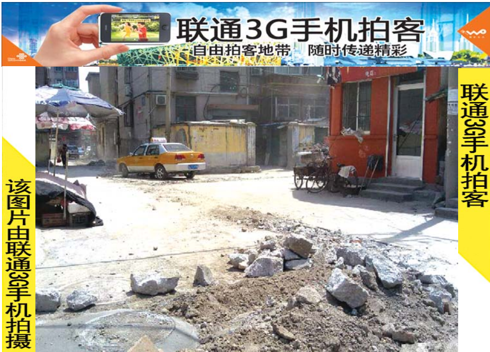
小区主路上的土堆。本报记者 陈新 摄 泰安市自来水公司工作人员表示,目前正对主管线进行改造,整体改造完成后由社区统一恢复路面。升平社区工作人员则表示,路面恢复工作自来水公司负责,如果自来水公司有什么需要他们会帮忙协调。
