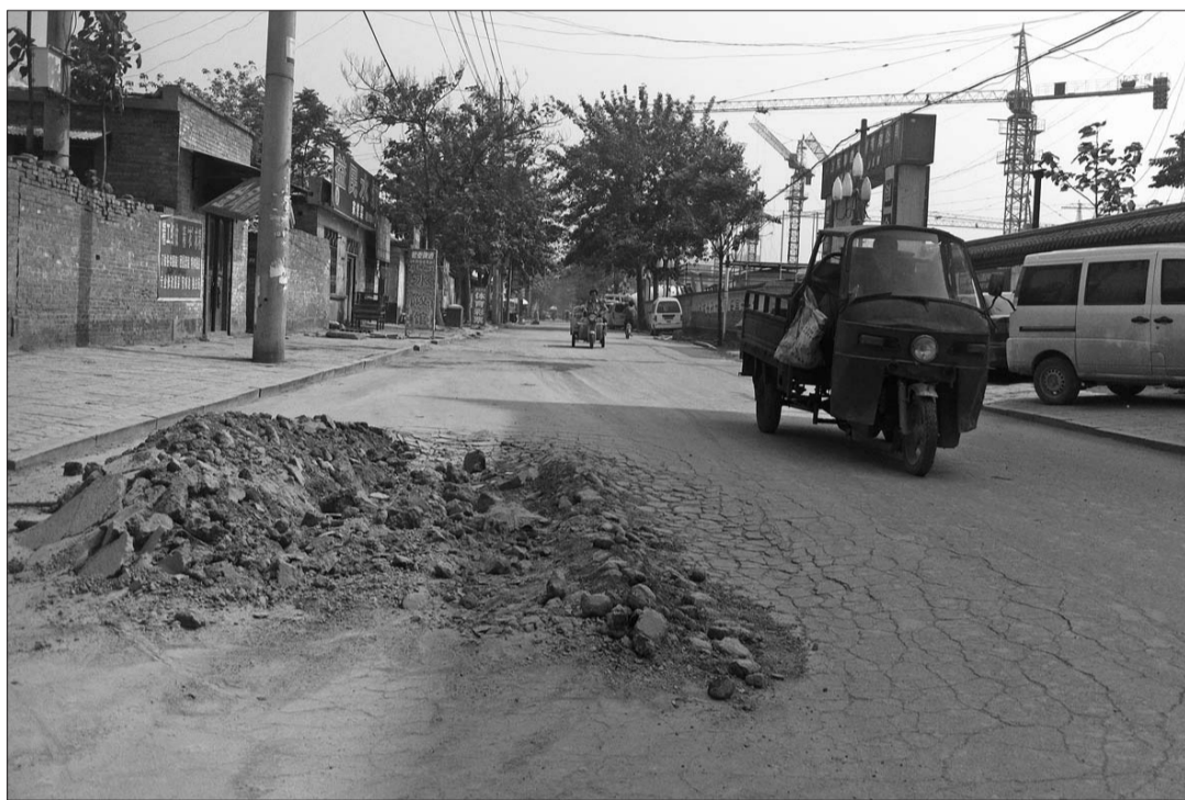
益民胡同重修后路面破损,出现大坑。
