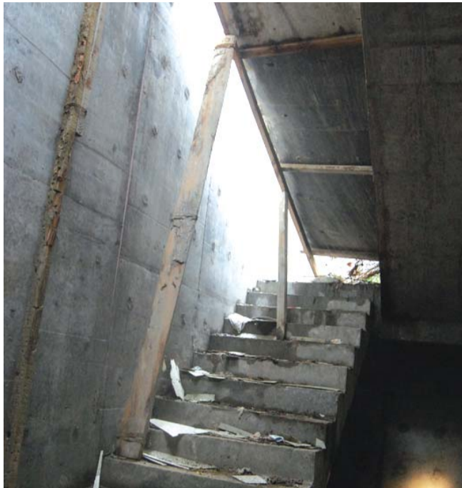
通道楼梯没护栏, 只用简易复合板遮盖。
