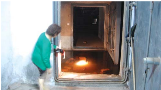
人防工程部分空间积水没过脚踝。
