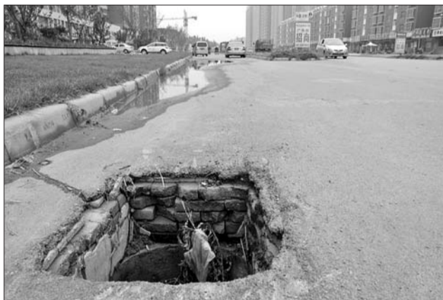
窨井盖缺失,周边没有任何警示标识。本报记者 张超 摄
