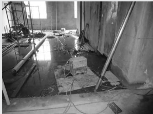
一家施工工地,电缆线浸泡在水中存隐患。
