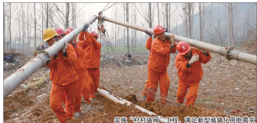
实施“村村强网”工程，满足新型城镇化用电需求
