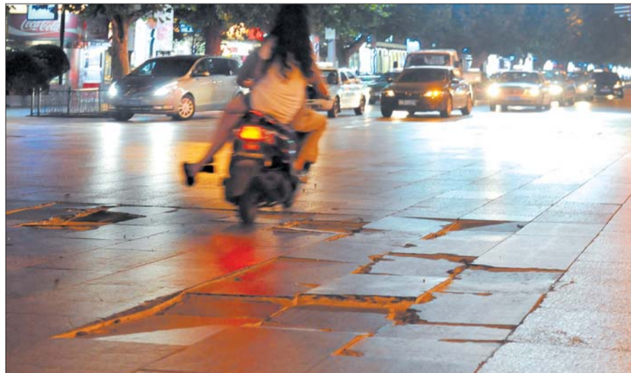
泉城路目前部分路段路面石板损毁比较严重。 本报记者 徐延春 摄
