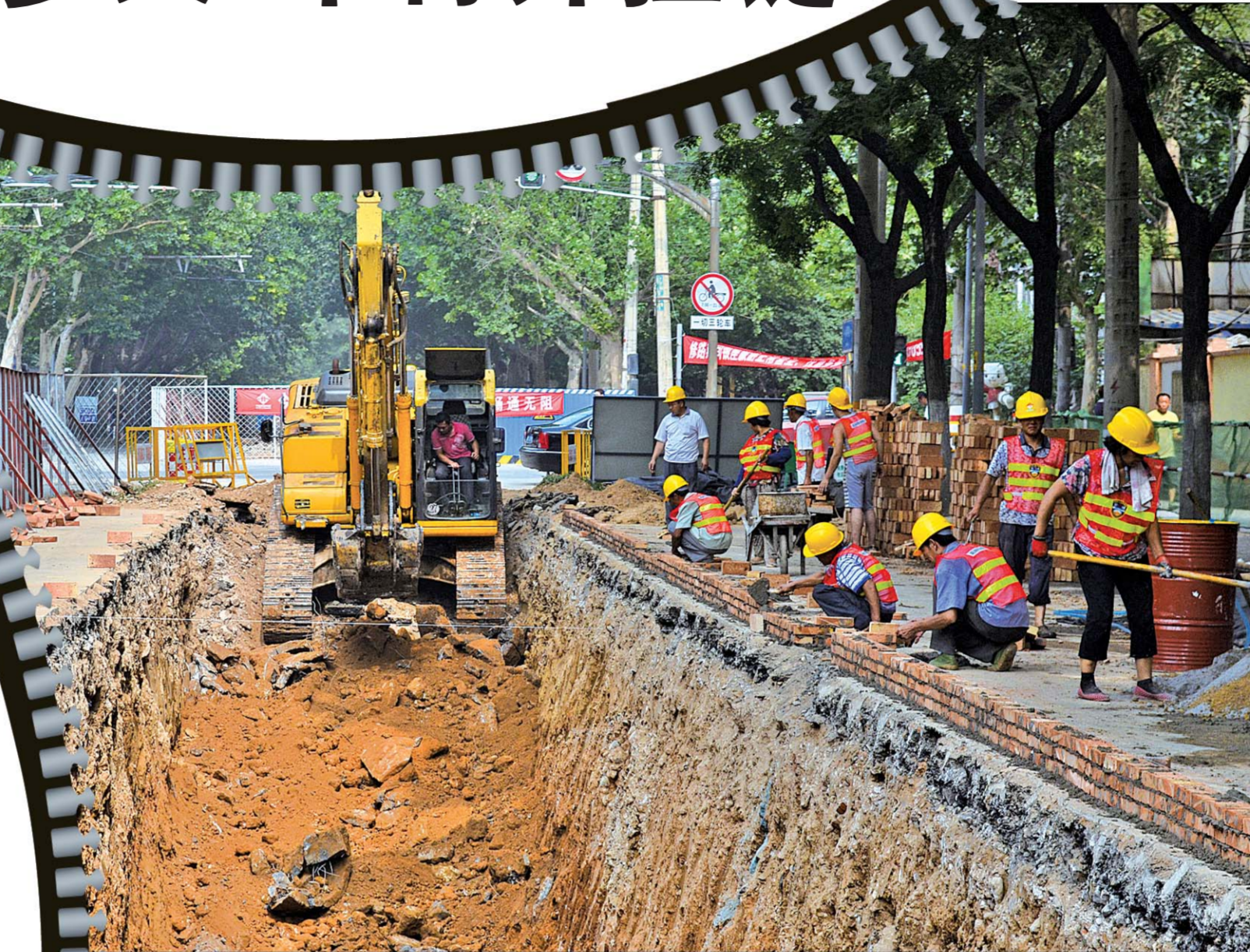
和平路路面开挖基本完成,正在建设电力沟。 本报记者 王光营 摄
