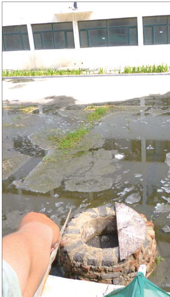
污水从污水井倒流出来,路面一片污糟。记者 王伟平 摄
