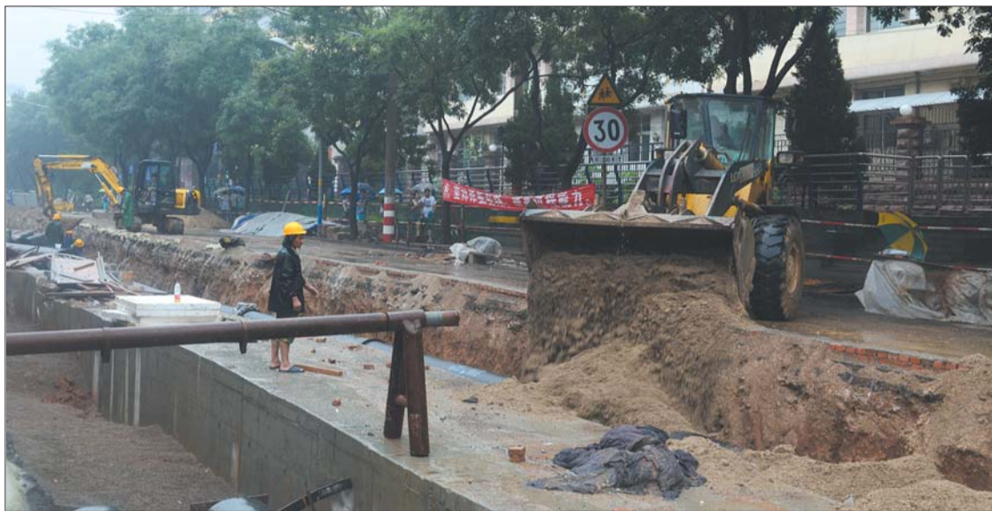
在和平路施工现场,工作人员冒雨对开挖路面进行回填。 本报记者 王光营 摄
