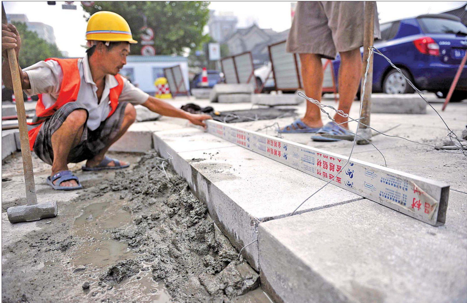
14日,在泉城路上,施工工人正在铺设石板,预计明后天可修补充完,但由于需要维护,所以通车还需等等。本报记者 王媛 摄
