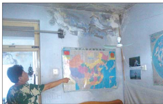
房间墙壁长满霉菌。本报记者 陈新 摄
