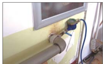
在莱山这家企业,消防栓成了水龙头。消防供图
