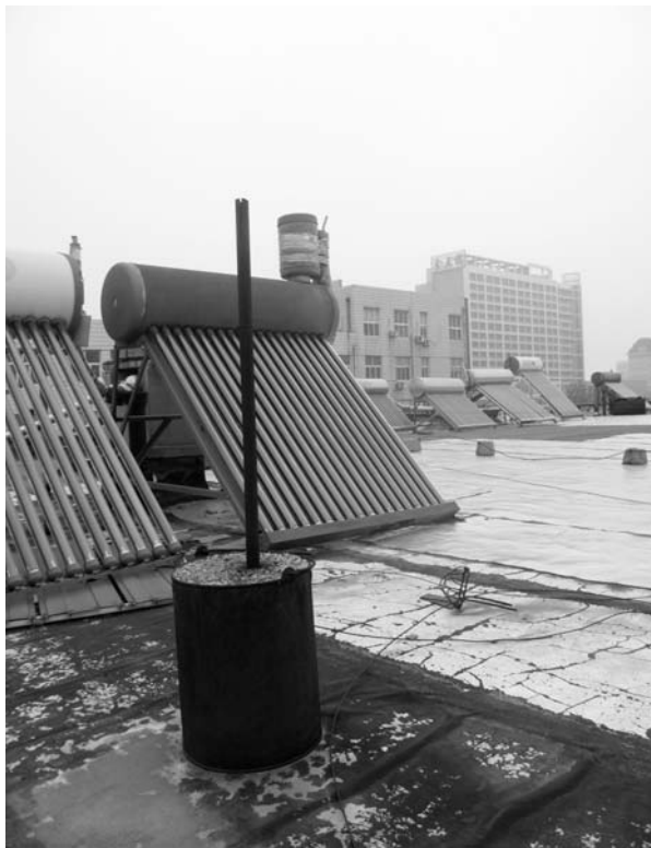
张店华光路某小区避雷针已经生锈,楼顶的太阳能热水器多高于避雷装置。 本报记者 张汝树 摄
