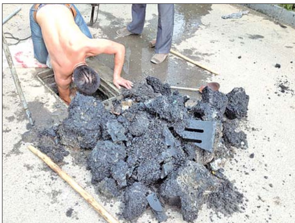
维修人员跪在地上,艰难地往外掏沥青。 本报记者 李璇 摄
