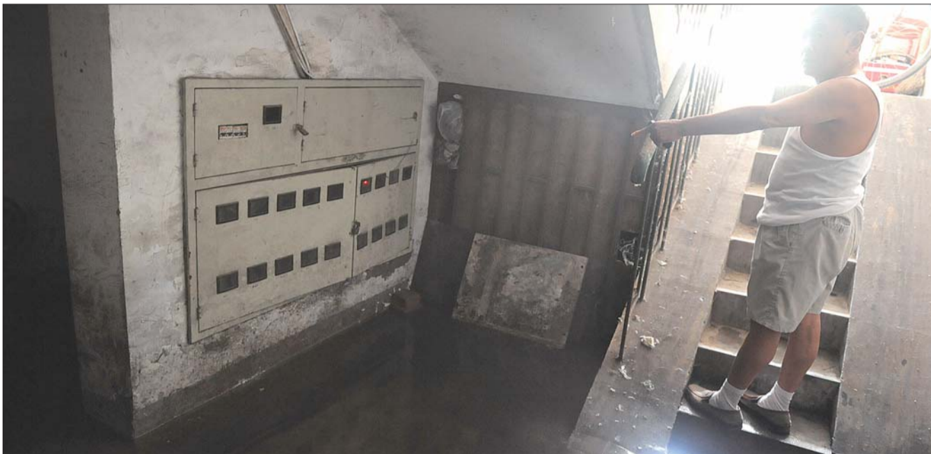
15号楼地下室积水在10到30厘米不等,最危险的是配电室就在地下室入口处,距离积水很近。 本报记者 左庆 摄
