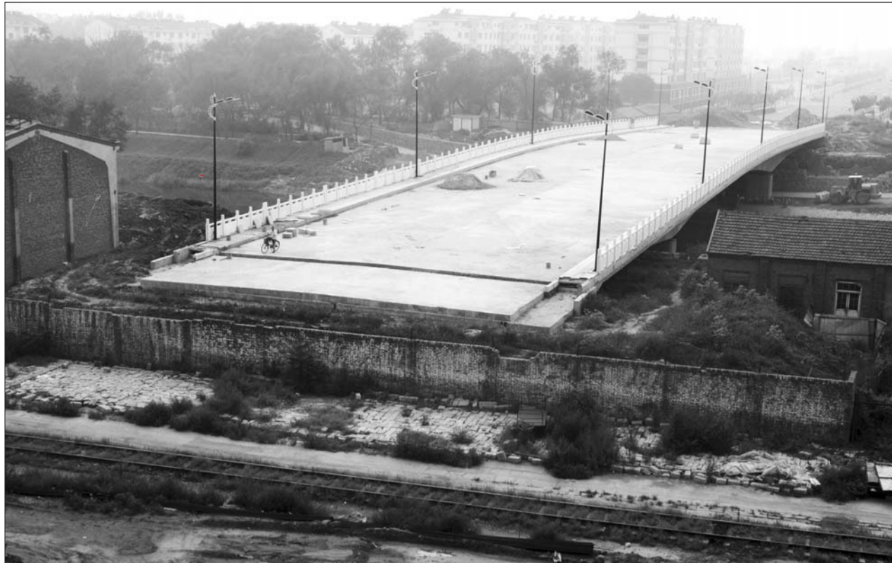
三八路上的运河大桥主体早已完工,路灯也已架设完毕,但两侧的引桥连接处却迟迟不动工。 本报记者 马志勇 摄
