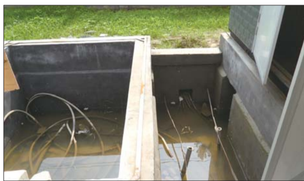
深坑里存有积水,且布满电线。本报记者 张建丽 摄
