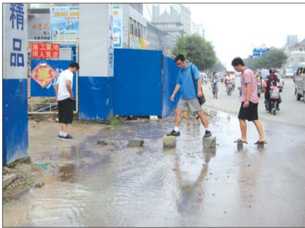
市民进出工地都踩在空心砖上。本报记者 张伟 摄
