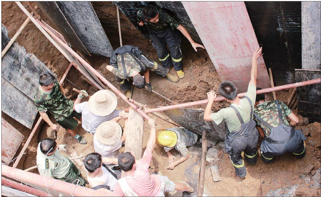
工人的下半身被困在塌陷的坑中。本报通讯员 马灵艳 摄
