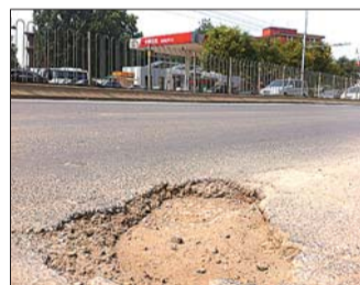
槐村街上一个马路大坑,已经存在了很长时间没人维修。
