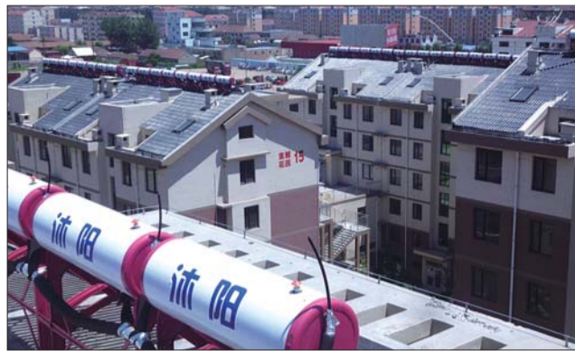
杨某安装的假“沐阳”牌太阳能。
