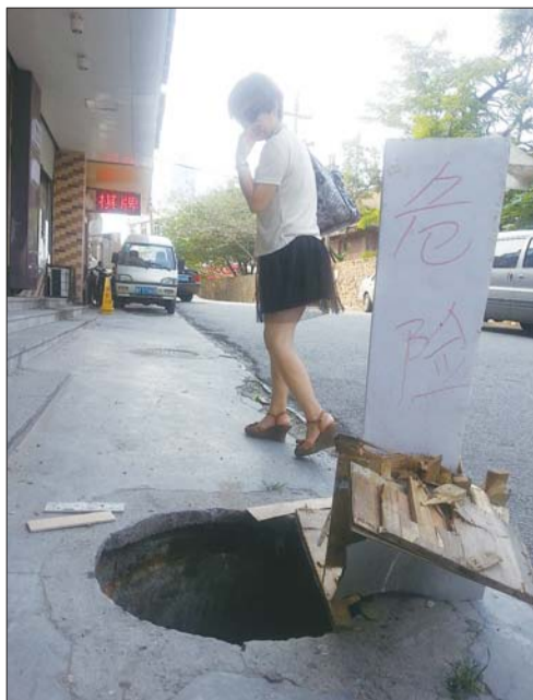
市民捂着鼻子从无盖井旁走过。 本报记者 侯艳艳 摄
