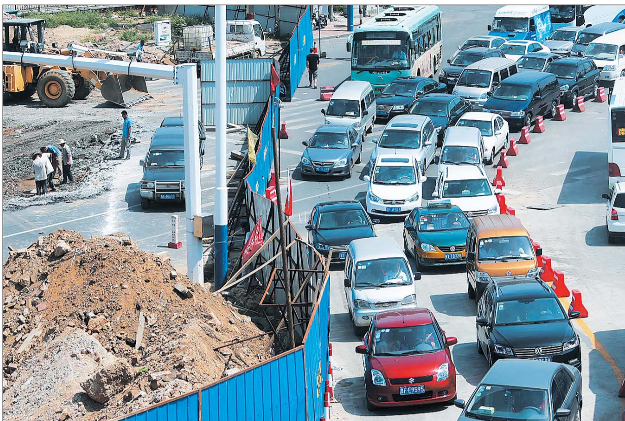
14日,只楚路部分路段施工,造成车辆拥堵。本报记者 高绪亮 摄
