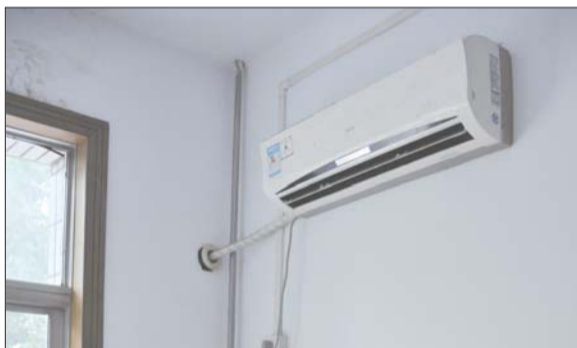
不少市民家里都安装了空调。 本报记者 樊伟宏 摄
