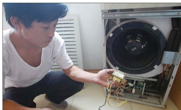
居民家的空调电压器被烧坏,需要更换。 本报记者 韩逸 摄
