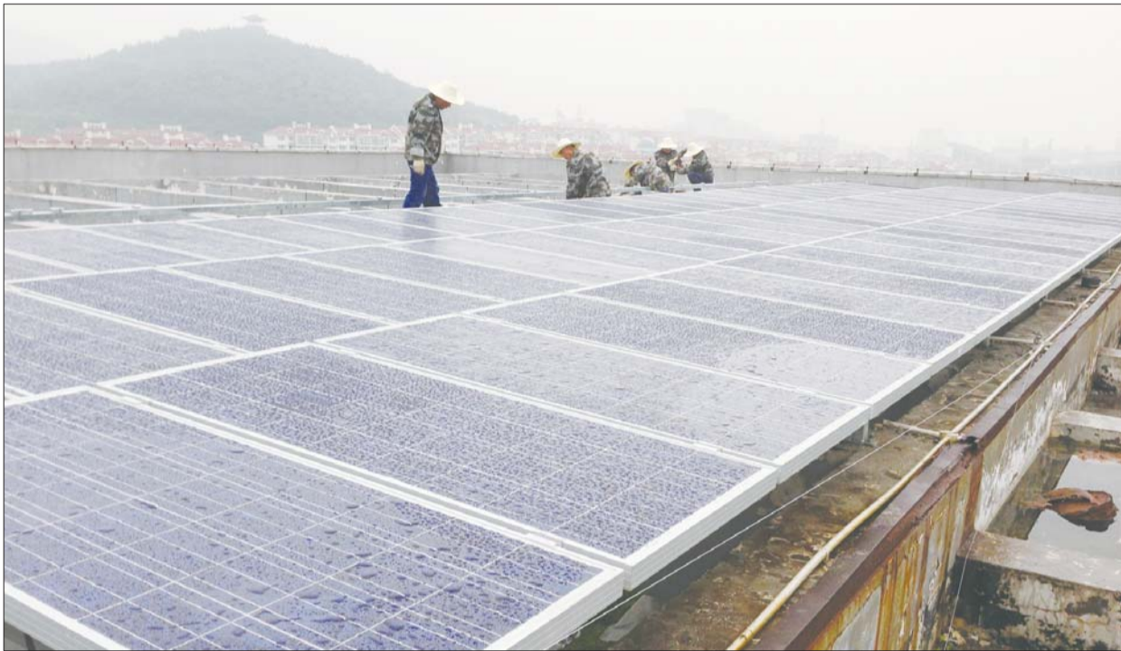
工作人员在住建局楼顶安装太阳能电池板。(资料片) 本报通讯员 自帅 摄
