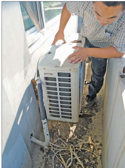
仪先生在住宅外接雨槽内装空调留下了隐患。
