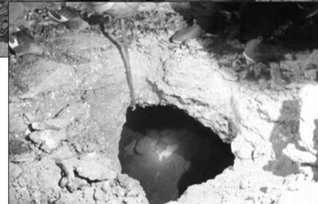
▶东风街文化路口地下现长6米暗坑。
