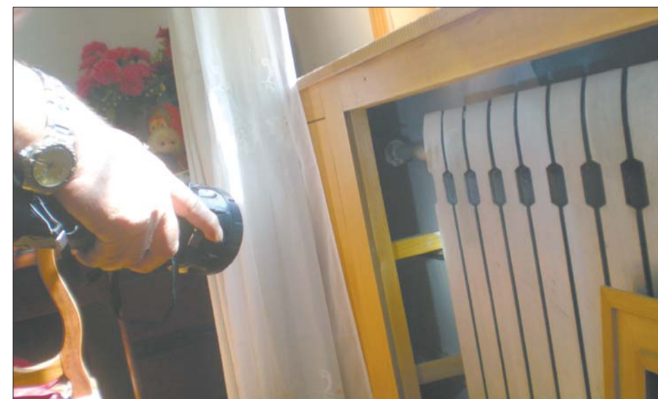
魏先生介绍暖气片的进出水开关。见习记者 刘树升 摄
