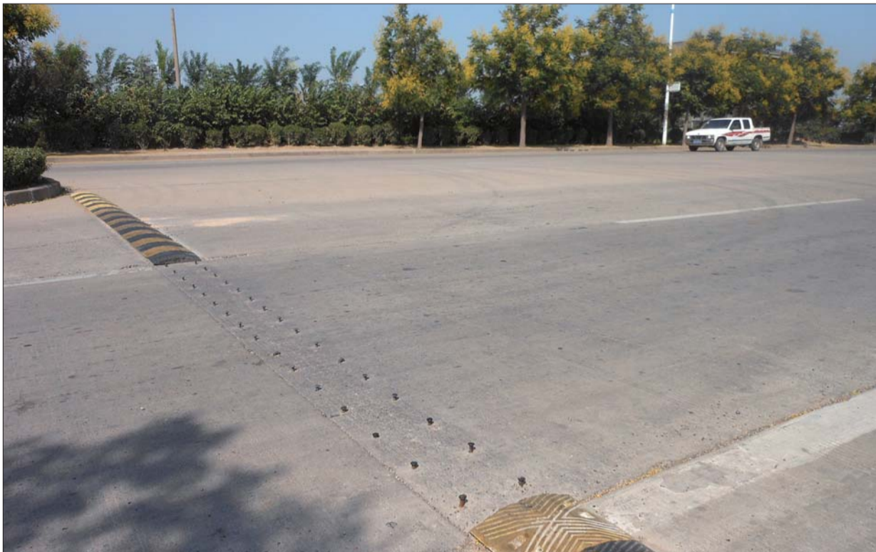
破损的减速带露出了可怕的“钢牙”。
