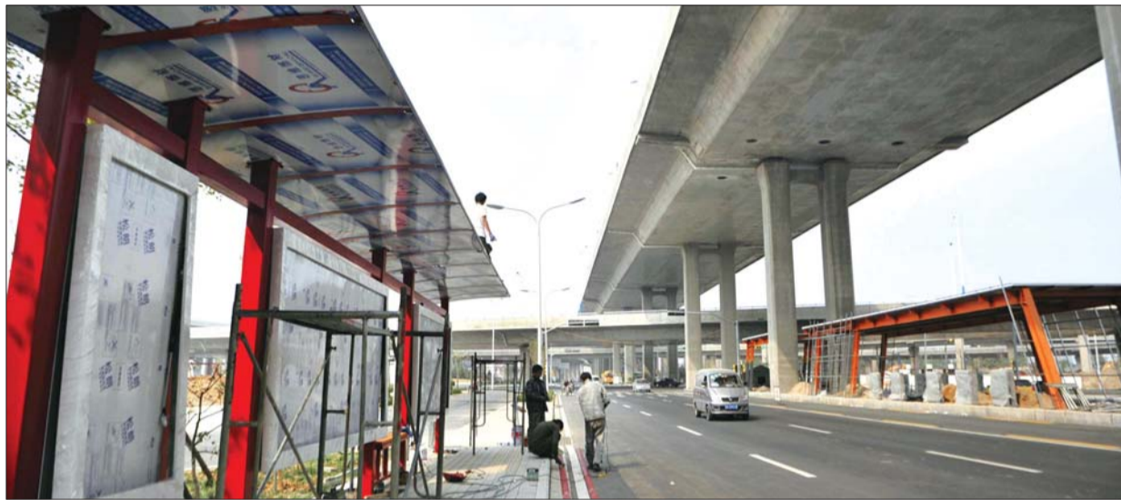
8日,在二环西路崭新的公交站台和BRT站台正在紧张施工。 本报记者 王媛 摄
