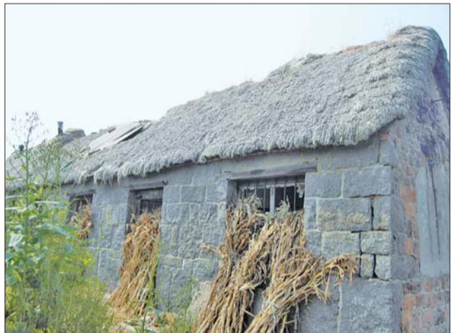
马山寨,一栋无人居住的海草房已坍塌。
